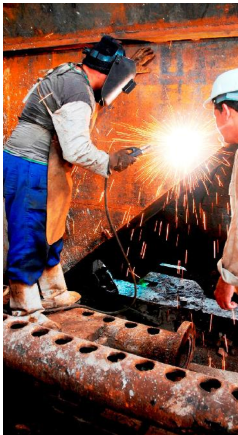
Entre las labores ejecutadas en la provincia de Cienfuegos estuvo la reparación de los centrales azucareros. | foto: Modesto Gutiérrez, ACN
