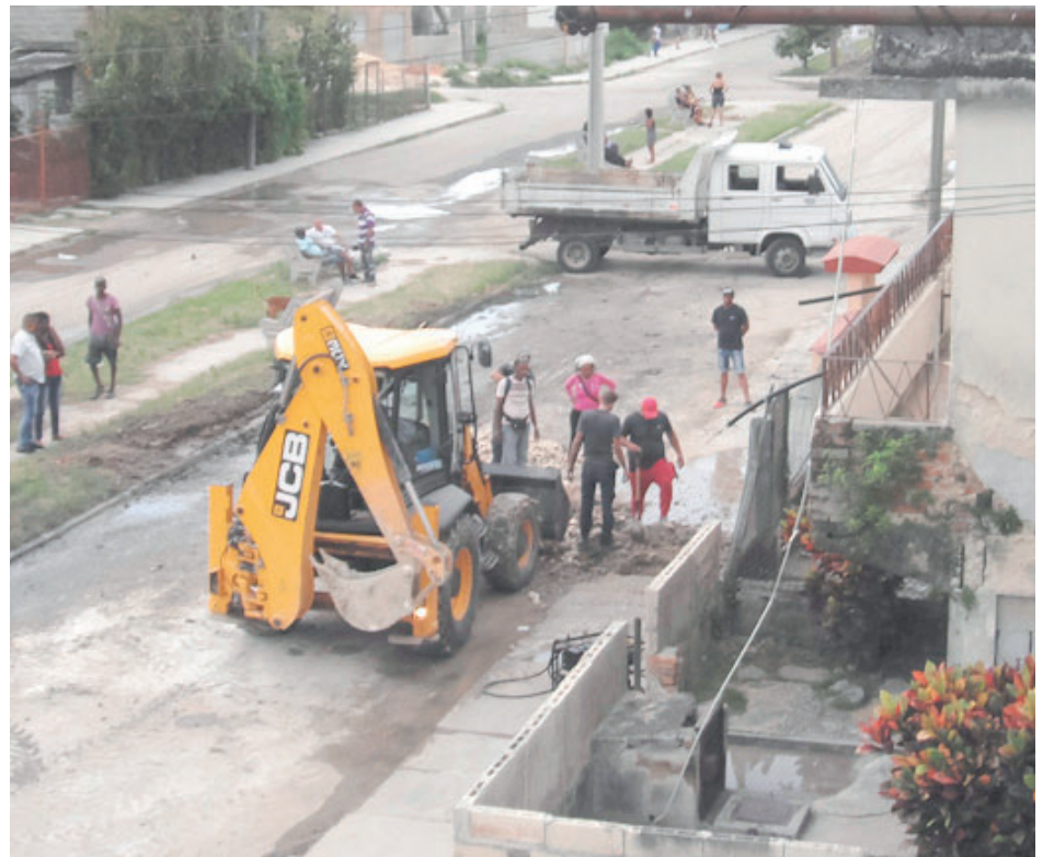
A mediados de junio divulgamos una foto bajo el título ¿Avenida Independencia o del agua?, que denunciaba el vertimiento de agua potable en la avenida Independencia, entre Paz y Reforma, en el reparto Martí. Para satisfacción de los vecinos ya el problema fue solucionado por una brigada de la empresa Aguas de La Habana, así lo constató nuestro fotoreportero. | APV | foto: Agustín Borrego
