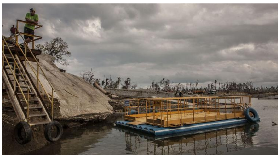
Se acondicionan dos patanas con capacidad para trasladar a 40 personas y 3,5 toneladas, hasta que se reconstruya el puente sobre el río Toa.
