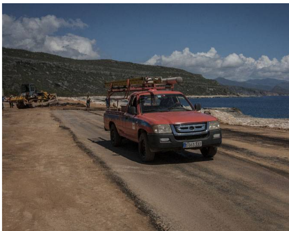
Con el nuevo asfalto se borran las huellas dejadas por Matthew al vial en la zona del Bate Bate.
