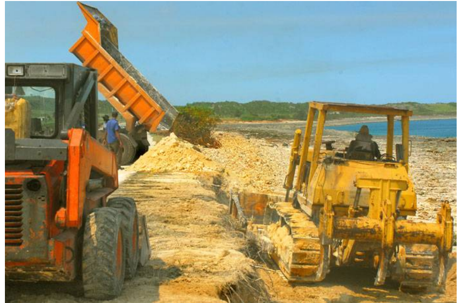
Entre 800 y mil metros cúbicos de tierra tiran diariamente los camiones y son compactados para reparar la zona dañada.
