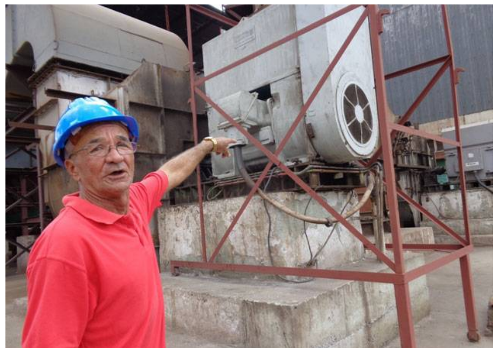
El apagado de este motor de la planta de depuración de humo genera el ahorro de unos 7 mil kiloWatt de electricidad diariamente.
