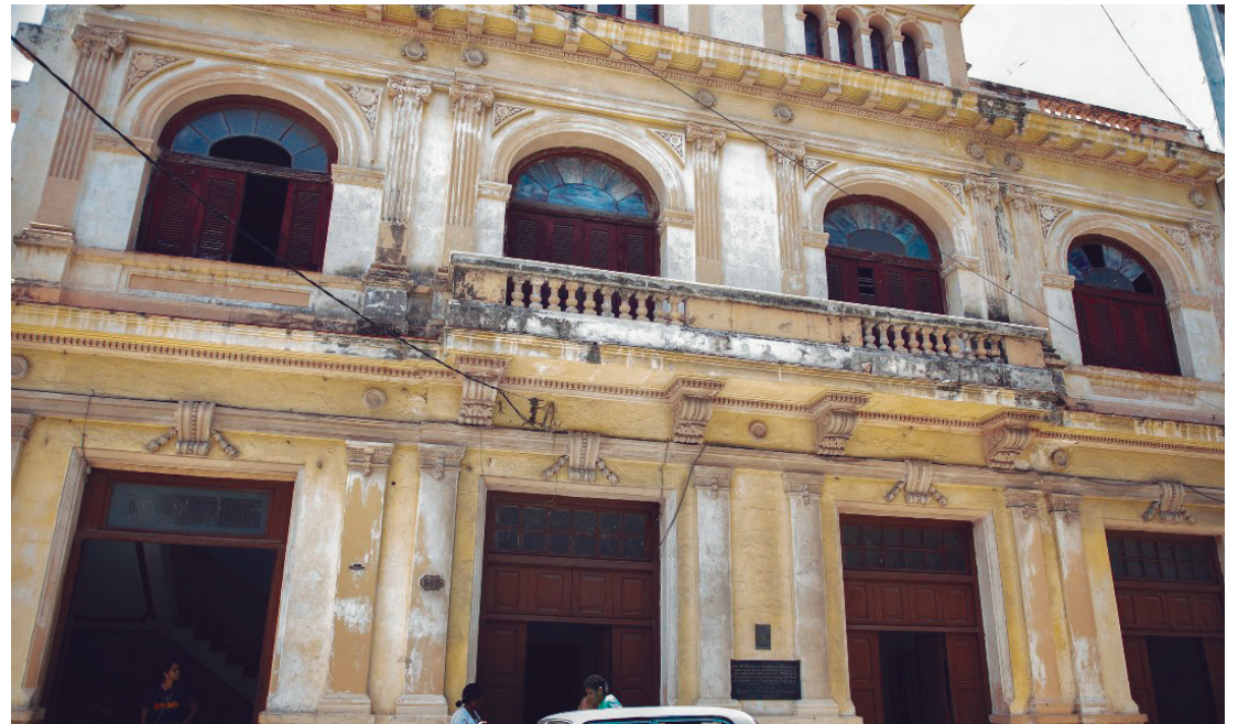
Justo en el año de su centenario el edificio muestra las huellas de la falta de mantenimiento.
