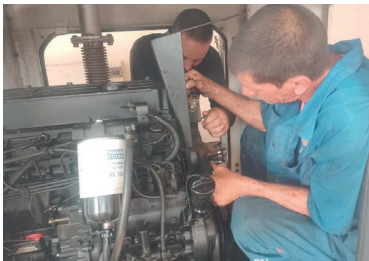
Mantener el servicio de asistencia técnica a casi 500 grupos electrógenos de emergencia en el territorio avileño es el principal desafío del colectivo. | foto: Del autor
