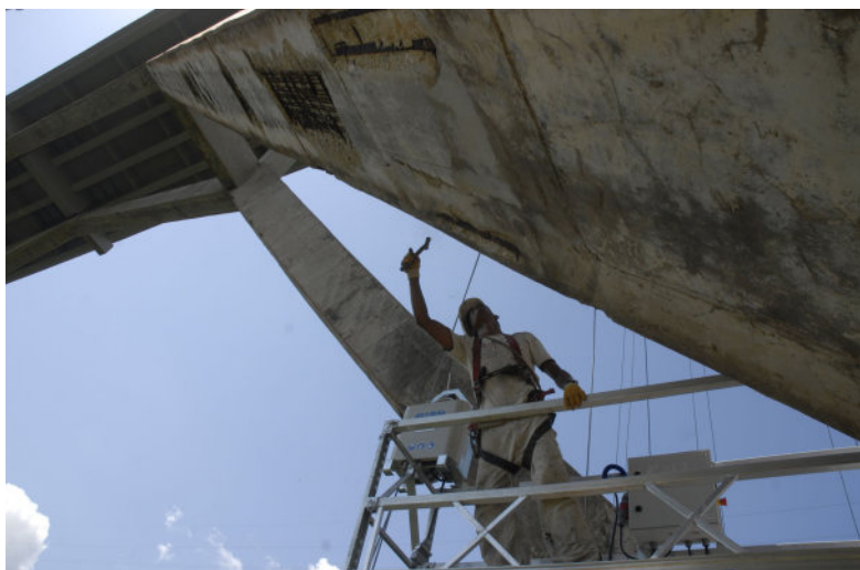
Para finales de este año está previsto concluir la reparación capital y así mantener la vitalidad que le corresponde tener como valiosa joya.
