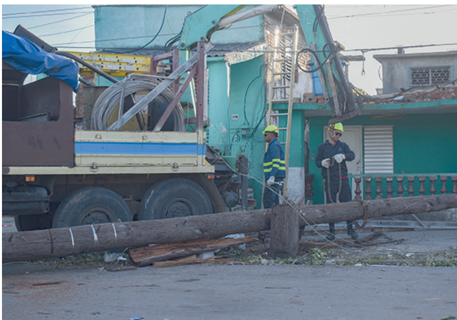
Los daños a los postes de electricidad son altos. La fuerza de los vientos los quebró y recostó.
