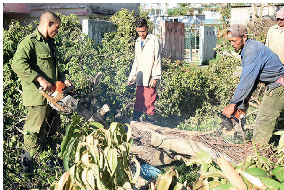
Integrantes de la brigada de motoserreros de Mayabeque en plena faena en el saneamiento de la ciudad de Pinar del Río. | foto: Alejandro Acosta
