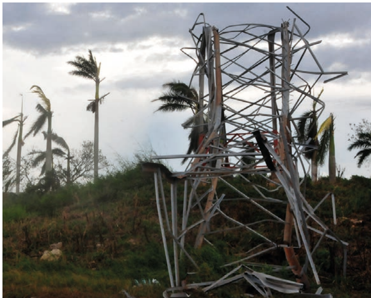
A la derecha puede verse la torre derribada y retorcida por el huracán.
