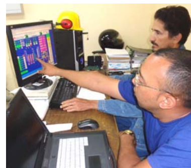
Los ingenieros Yvan Palma (en primer plano) y Gilberto Julio Pérez Cancio manejan el proceso productivo mediante un clic.
