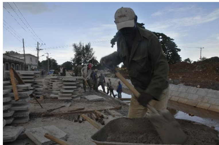
Todos agradecen la construcción del canal de drenaje en la cabecera provincial.
