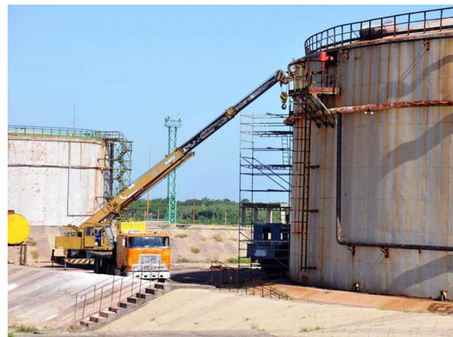
En uno de los tanques de 20 mil metros cúbicos de capacidad se elimina la oxidación en la parte exterior. | foto: Isel Morfa (Cuenpetrol S.A.)
