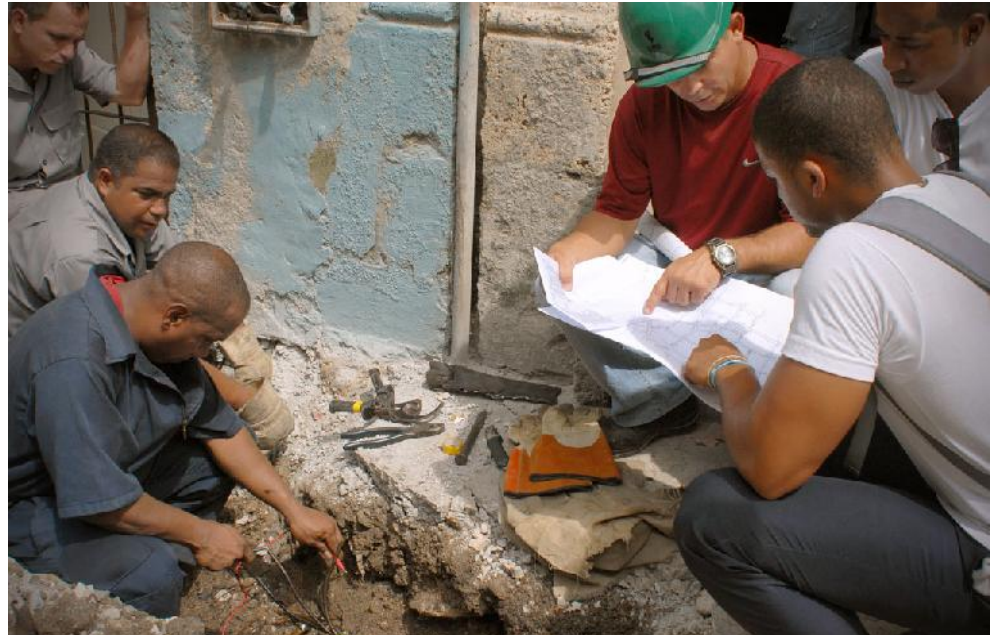
A pie de obra, jóvenes ingenieros junto con operarios experimentados comprueban los conductores acabados de empalmar.
