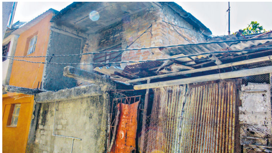
El estado deplorable de algunas de las viviendas de Las Margaritas a tres años de iniciados los trabajos de construcción.
