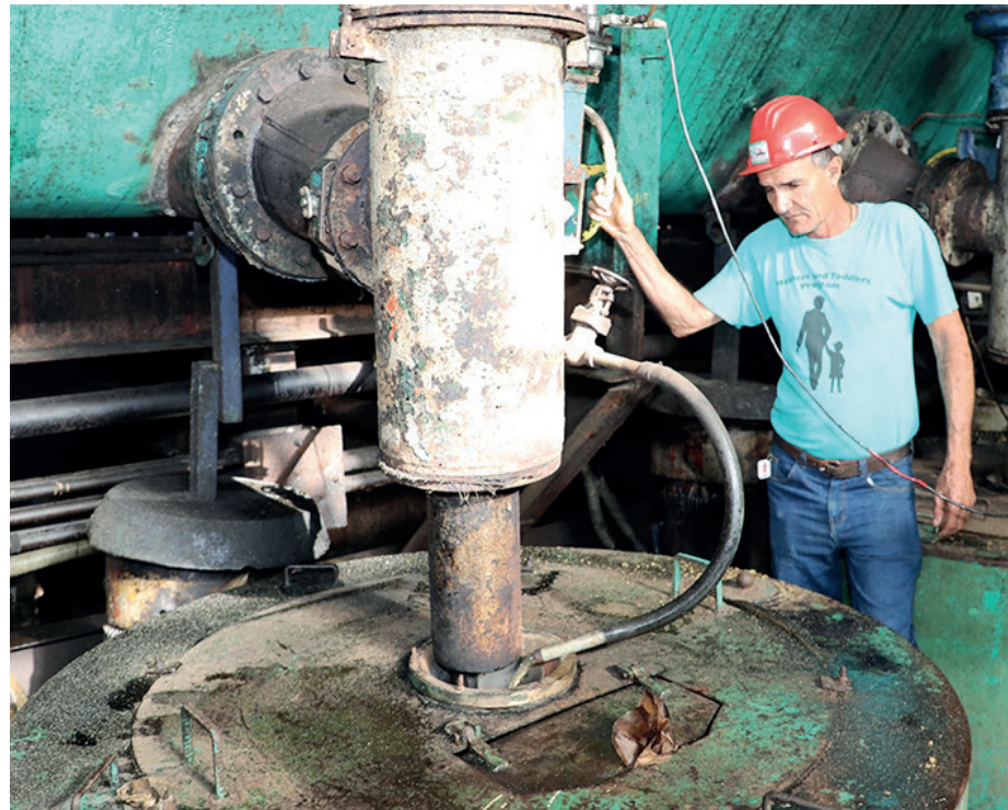
Eliecer Castro Sosa alterna su responsabilidad como jefe de mantenimiento de centrífugas con labores de operador.
